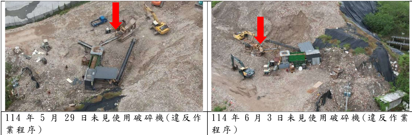
圖 12、鋸○公司再利用製程使用設備問題與缺失
