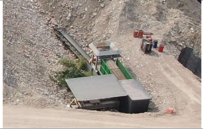
114年2月19日設備本體低於周圍營建廢棄混合物，輸送帶等高於周圍營建廢棄混合物，無法順利完成輸送流程
