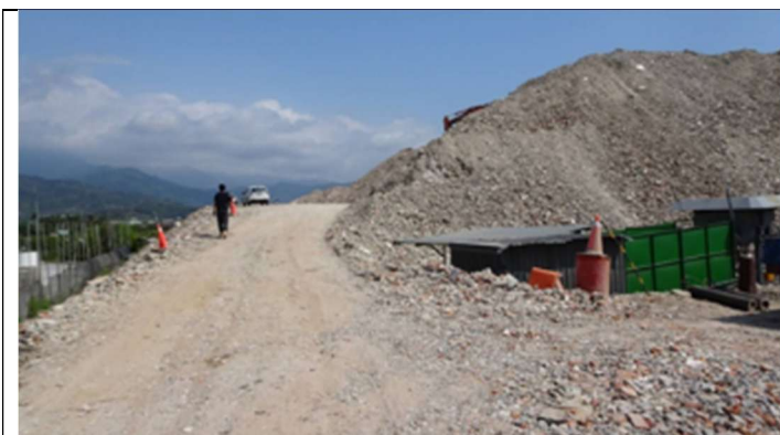
車輛通行路徑及區域未有充足灑水導致塵土飛揚
