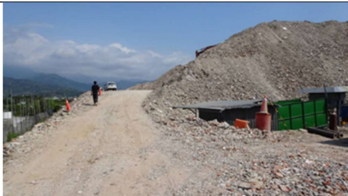
車輛通行路徑及區域未有充足灑水導致塵土飛揚
