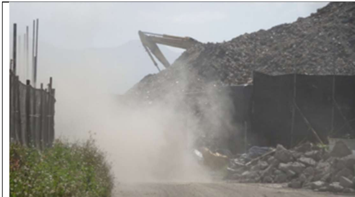
怪手作業造成逸散性粒狀污染物
