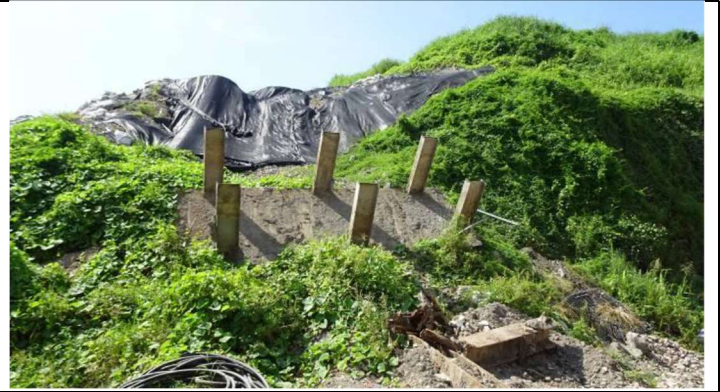
113年10月18日震動篩底座未見本體設備
