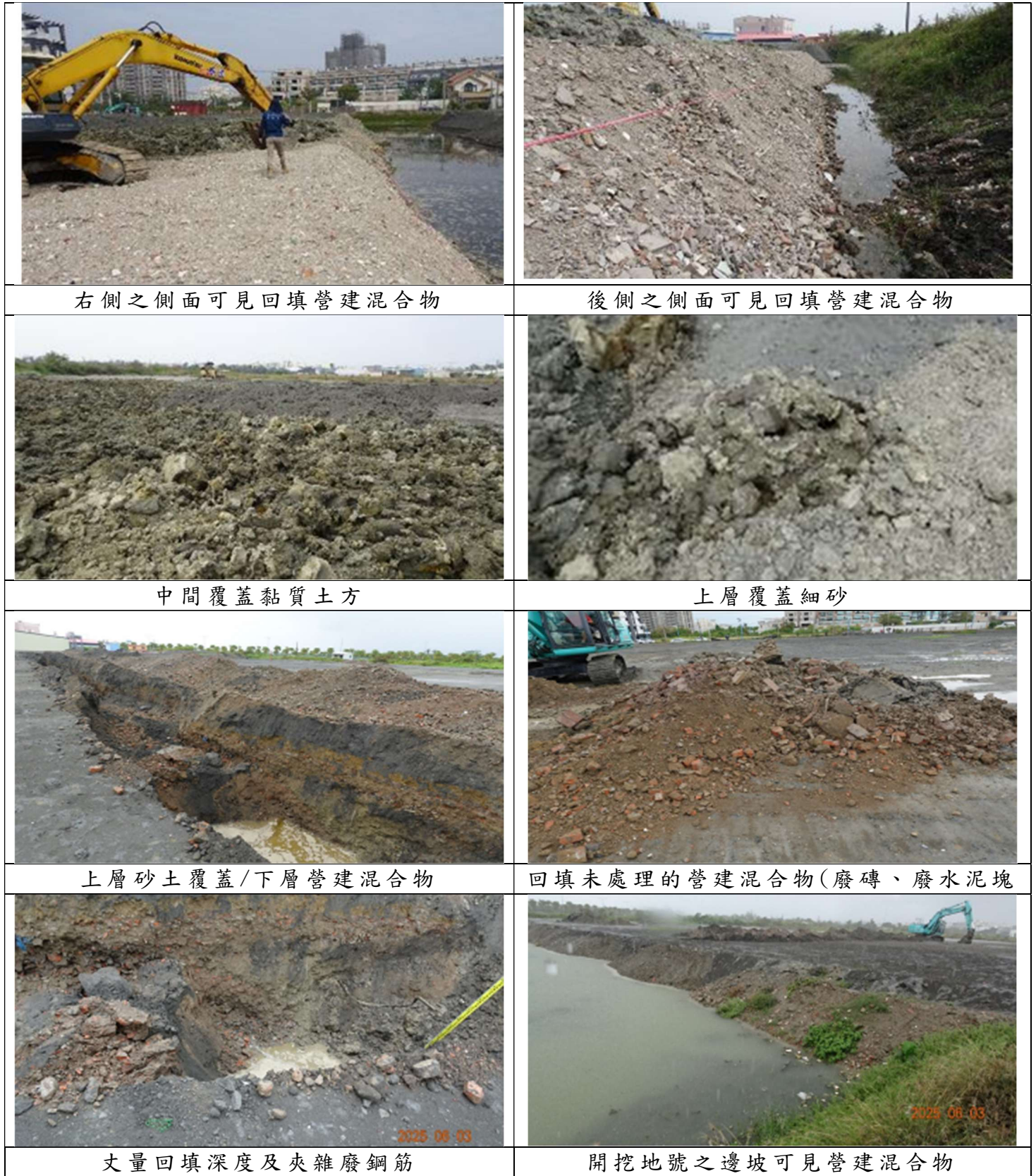
圖 9、大東段地號違法堆置回填廢棄物情形
