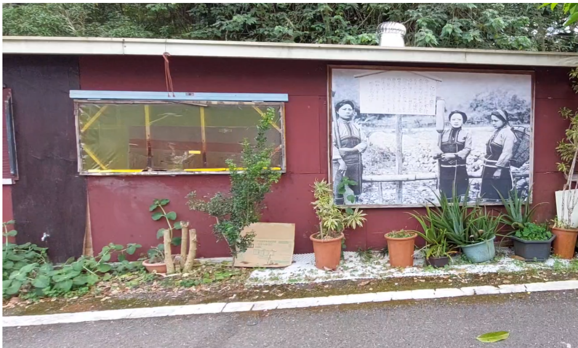
照片3 日月潭伊達邵臨時安置社區門窗損壞、空間不足
