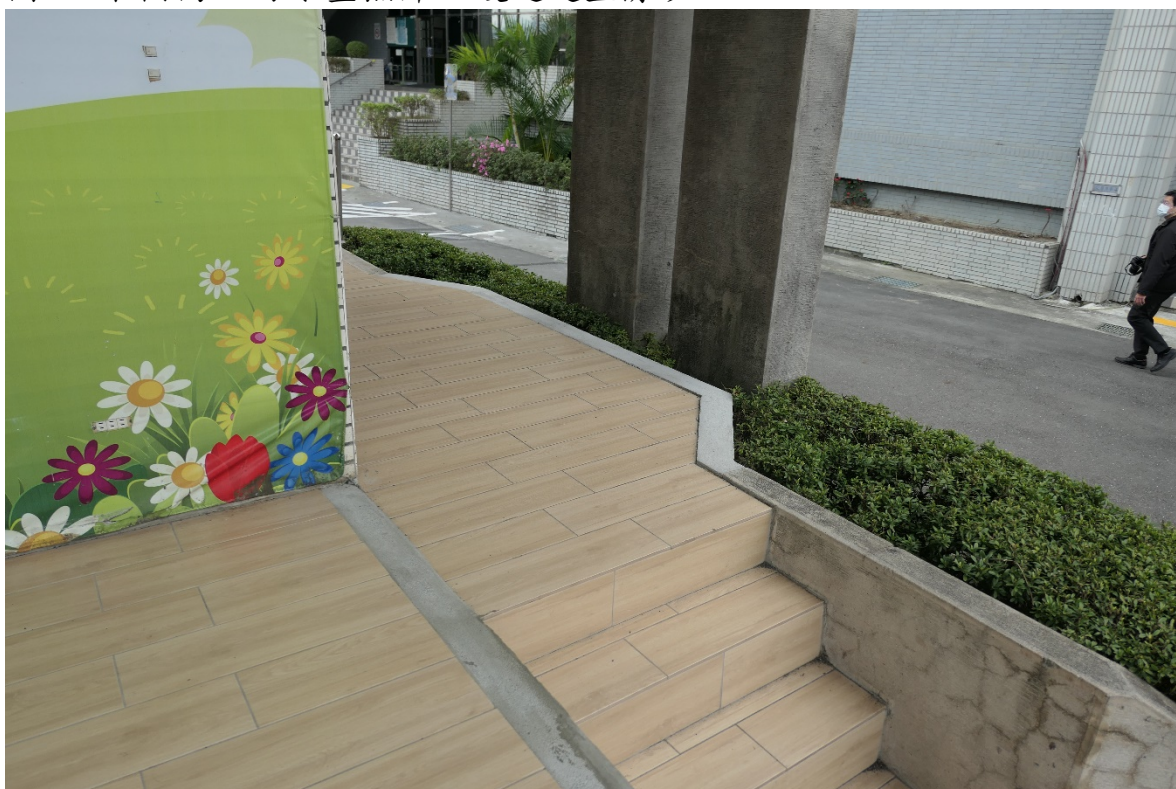
圖6 木柵高工司令臺無障礙輪椅轉彎處
