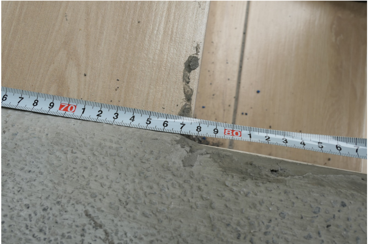
圖7 木柵高工司令臺無障礙設施建置情形（輪椅轉彎處約77.5公分）
