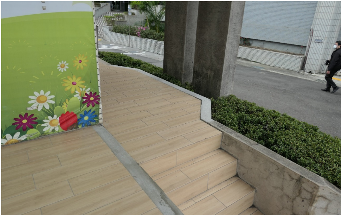
圖7 臺北市木柵高工司令臺無障礙設施建置情形
