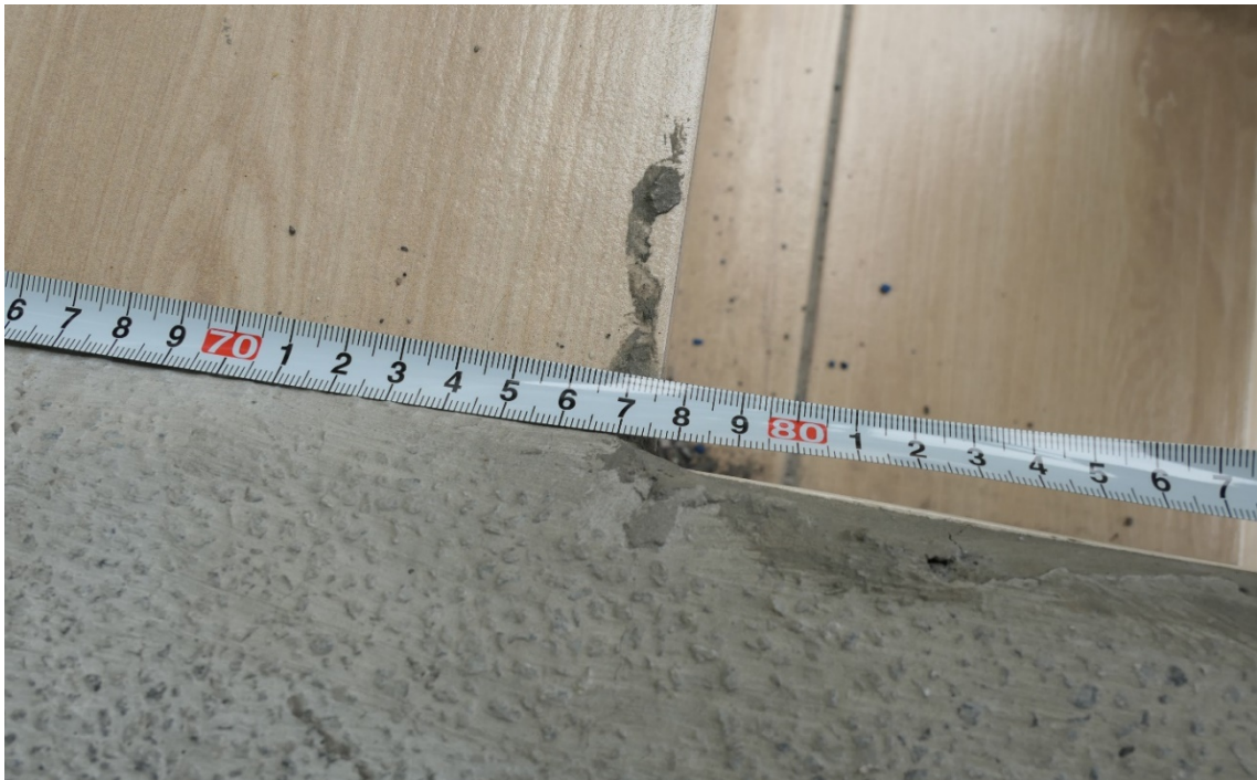
圖8 臺北市木柵高工司令臺無障礙設施建置情形（輪椅轉彎處約77.5公分）
