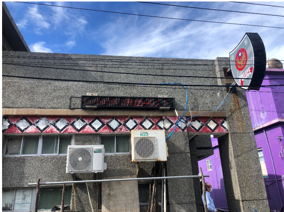
圖14 環境輻射監測站
