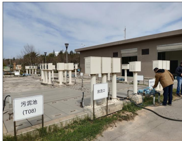
污水處理池槽
