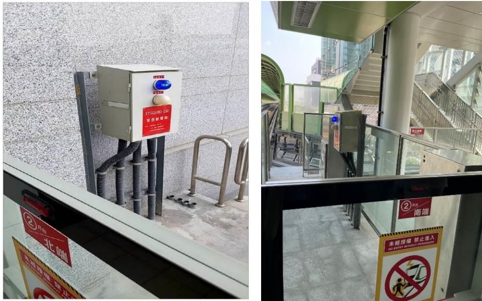
照片5 月台端牆門外方緊急斷電設備
