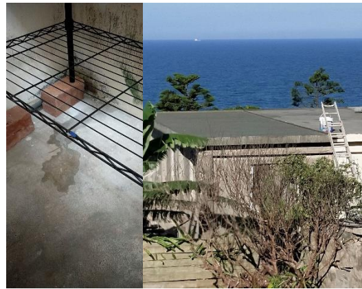
房屋內部漏水與防水修繕前後對比
