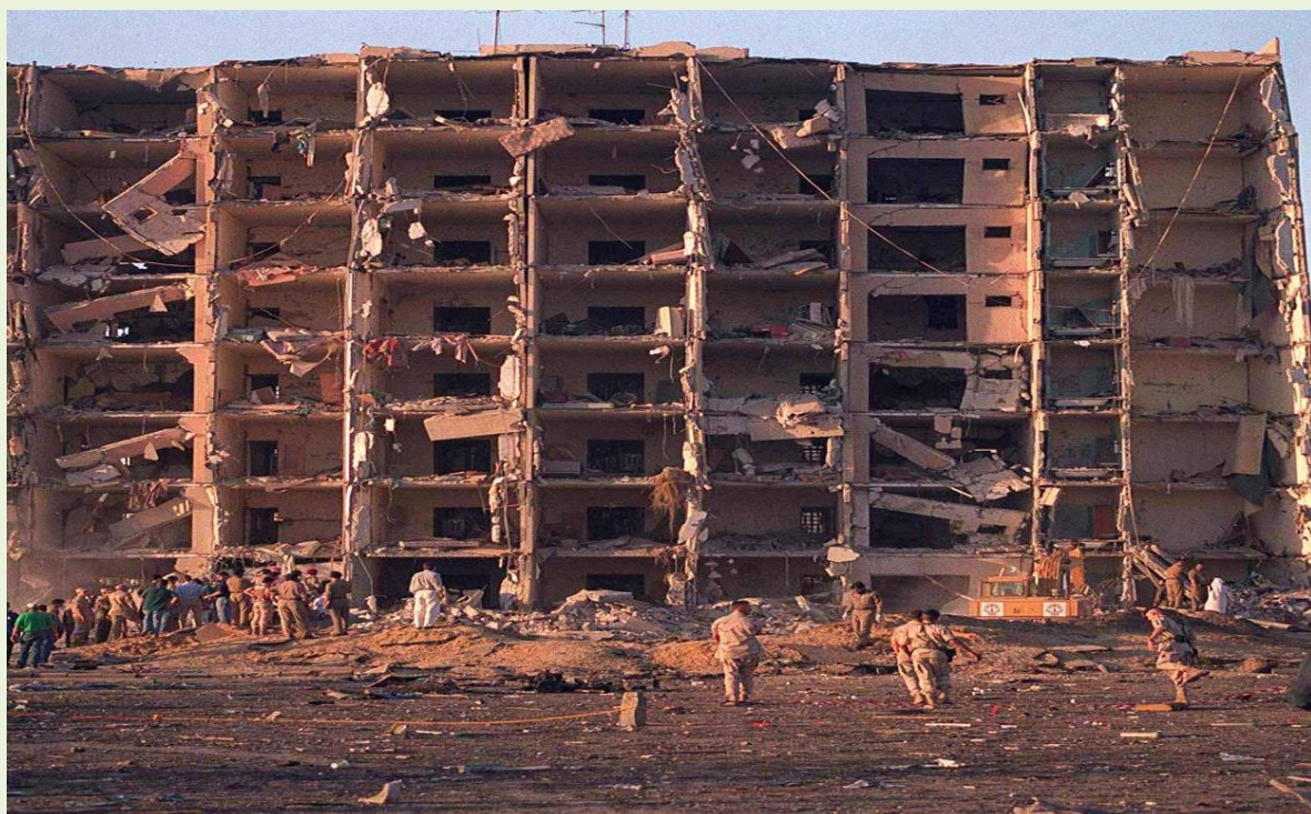
圖3 空襲後，大樓室內第2道牆後的狀況
