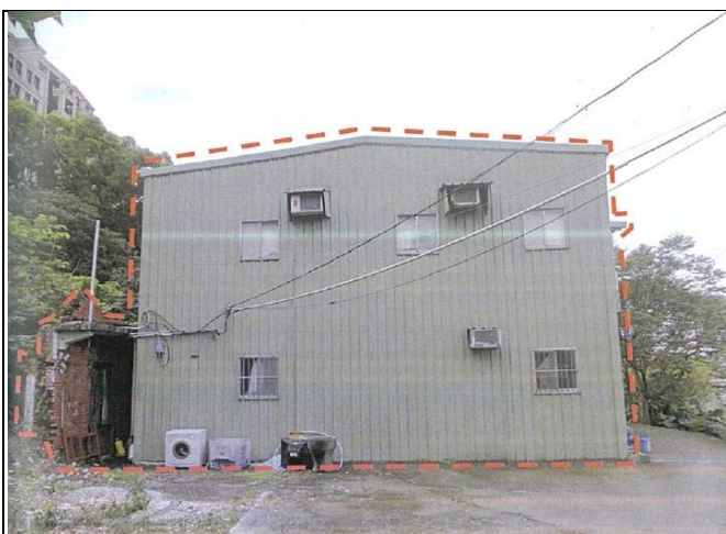
圖3 106年11月27日違建勘查照片
