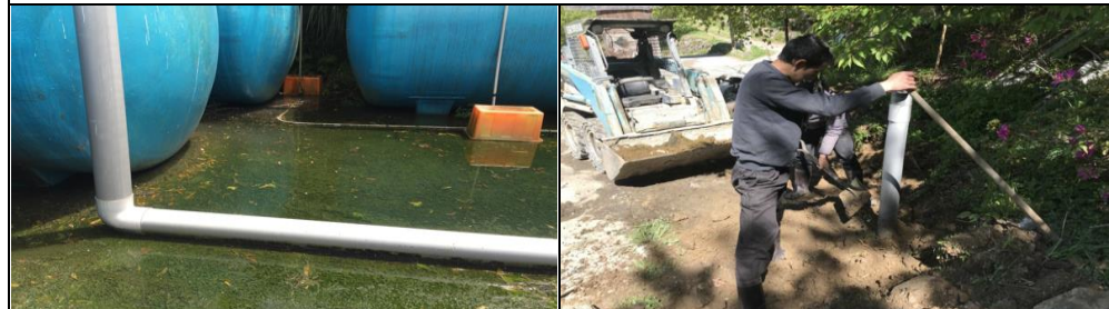
A區處理槽：進水井、藍色的污水處理槽，不斷的溢出來污水，污水就積在水泥地上。
