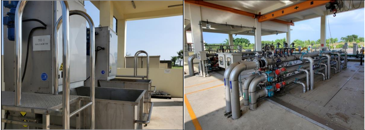
水資源回收中心處理設備
