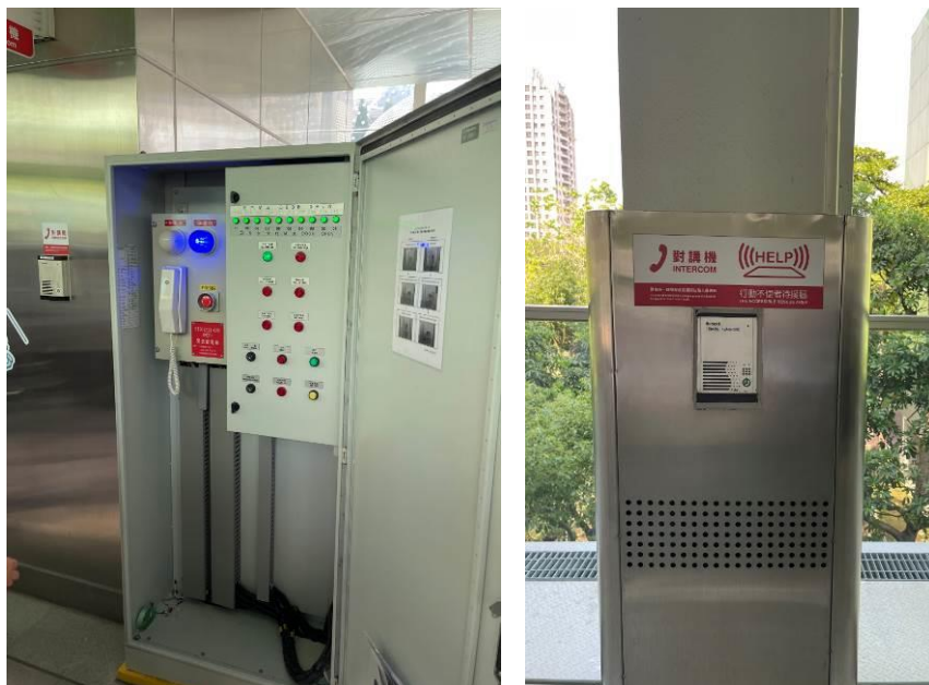
照片6 月台門控制盤上鎖箱體內緊急斷電設備(左)、月台對講機 (右)
