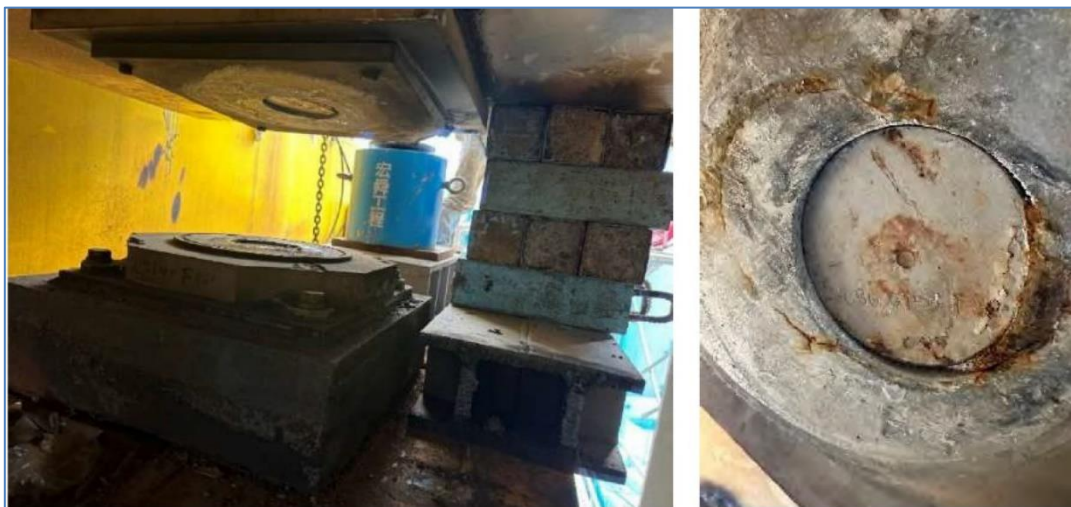
圖3 P1216鋼箱梁頂升後插銷卡在上盤之照片
