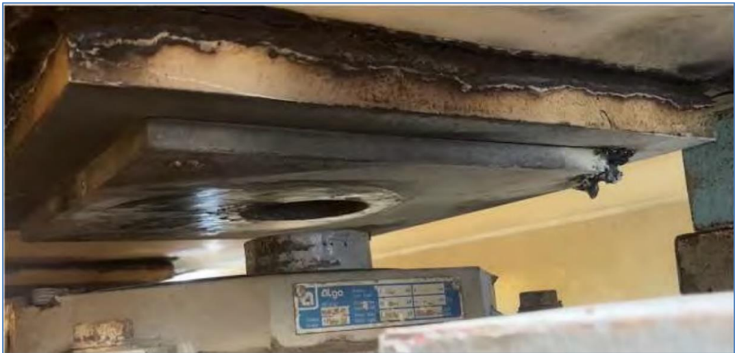
圖4 P1216上、下盤錯位後，鋼箱梁頂升後插銷掉落之照片
