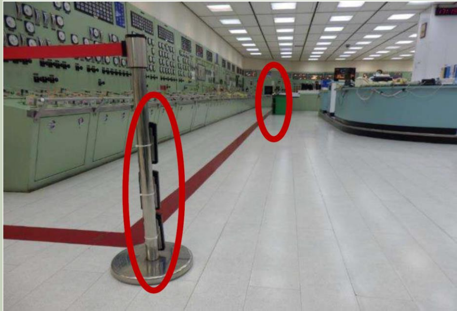
圖8 控制室盤面紅線區內增設紅外線入侵感應偵測儀
