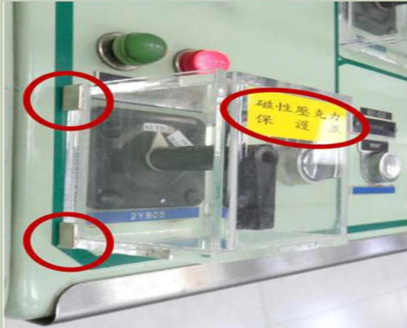
圖10 控制室操作盤面關鍵開關改善為具磁吸之壓克力保護罩
