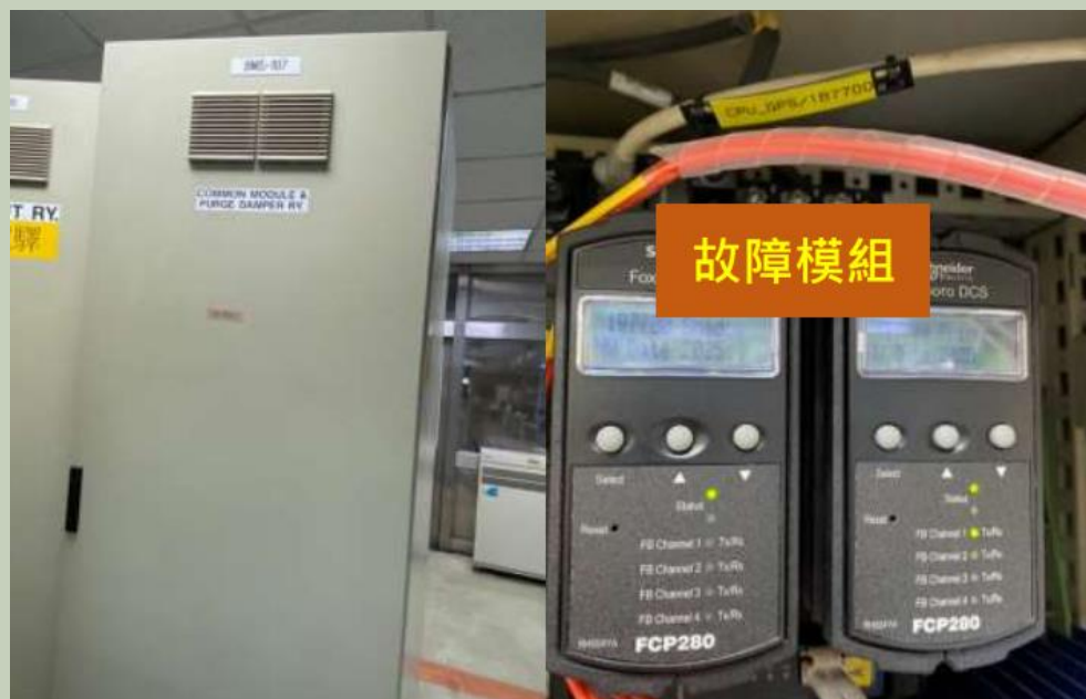
圖7 現場控制箱盤照片
