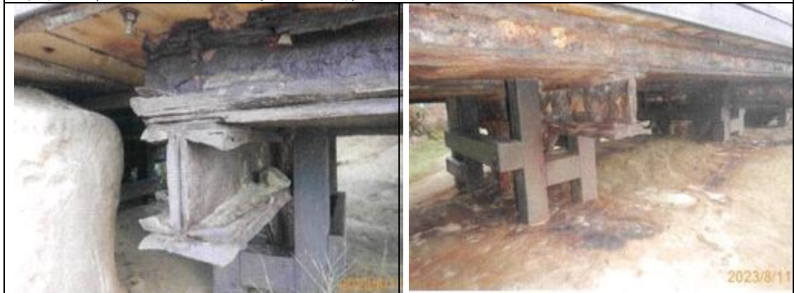
圖3 野柳地質公園景觀橋及木棧道（R木棧道）鋼構鏽蝕嚴重 資料來源：111-112年北觀管理處轄管橋梁及構造物巡檢工作委託技術服務案，第5次定期檢測成果報告書。
