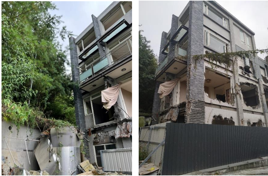
圖5 南投縣清境地區某旅館（屬大型違建）已拆除至無法使用
