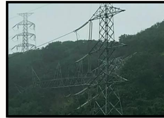
2號機輸電鐵塔倒塌
