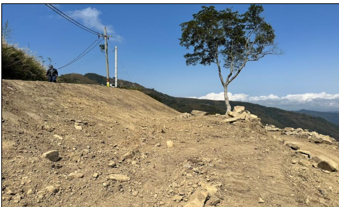
附圖4、新竹縣政府於112年3月16日至現場勘查，行為人未先擬具水土保持計畫書送核，擅自開挖整地、新增平台5處、修闢邊坡、新闢道路及堆積石塊等。
