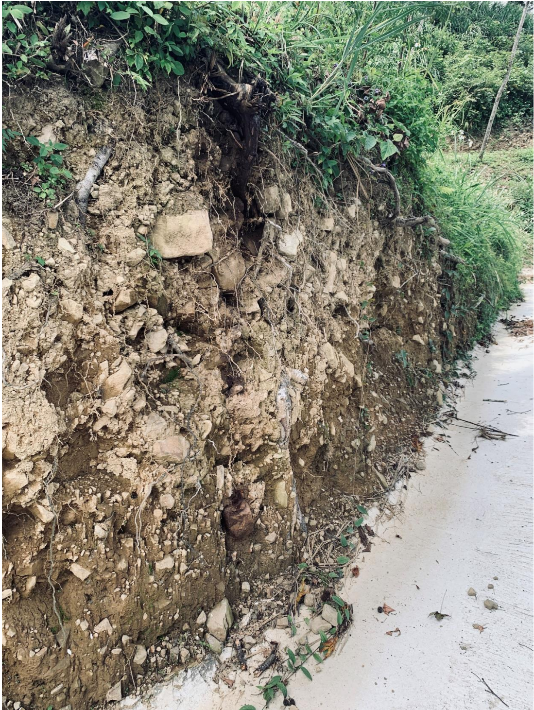
附圖3、施作農路開挖邊坡造成坡面裸露，無相關防護措施。 資料來源：本院履勘拍攝
