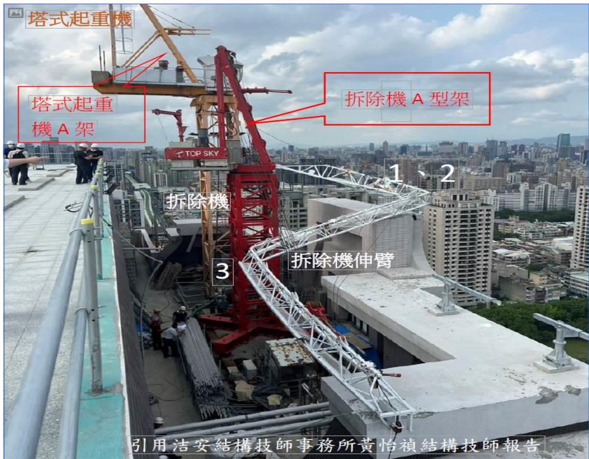
照片3 拆除機 TD2020 伸臂掉落於建築物屋頂
