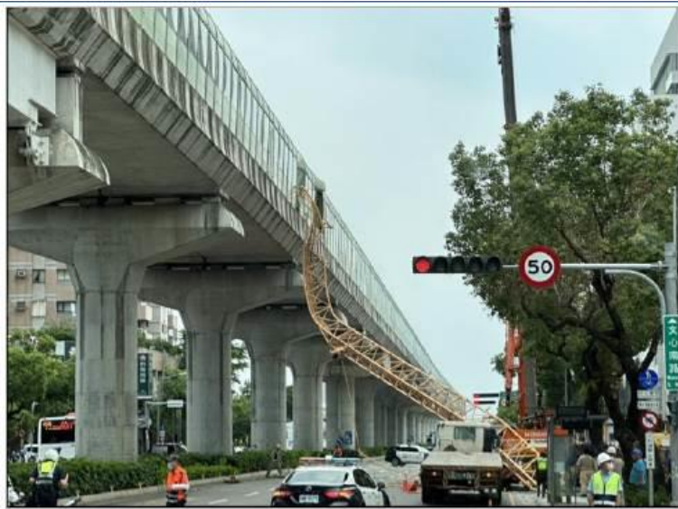
圖1 斷裂墜落之桁架侵入捷運路線
