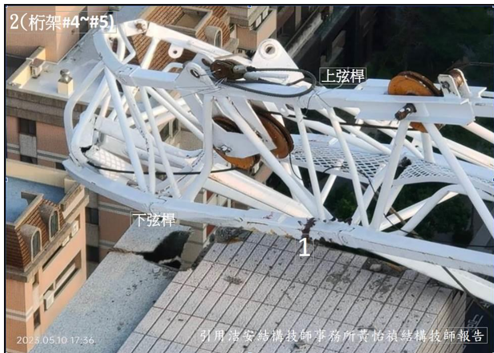
照片1 破壞點1為研判發生挫屈位置、破壞點2發生在伸臂桁架#4~#5節處
