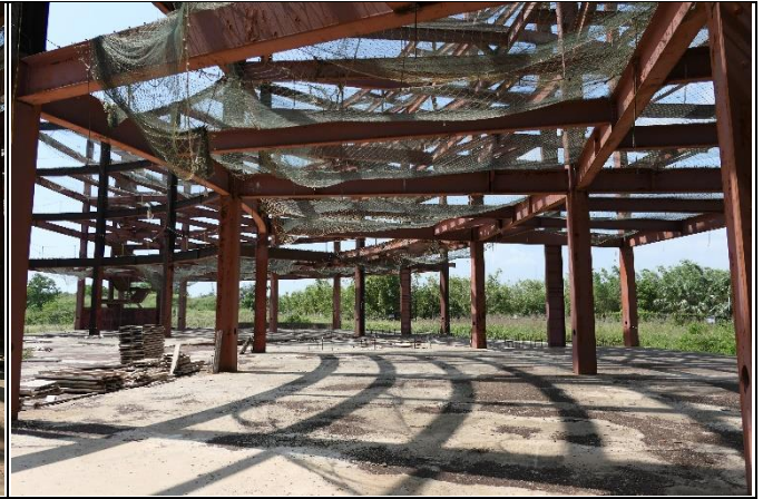
圖2 工區閒置情形，本院112年9月27日攝。
