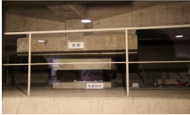
圖98 國立西洋美術館免震裝置
