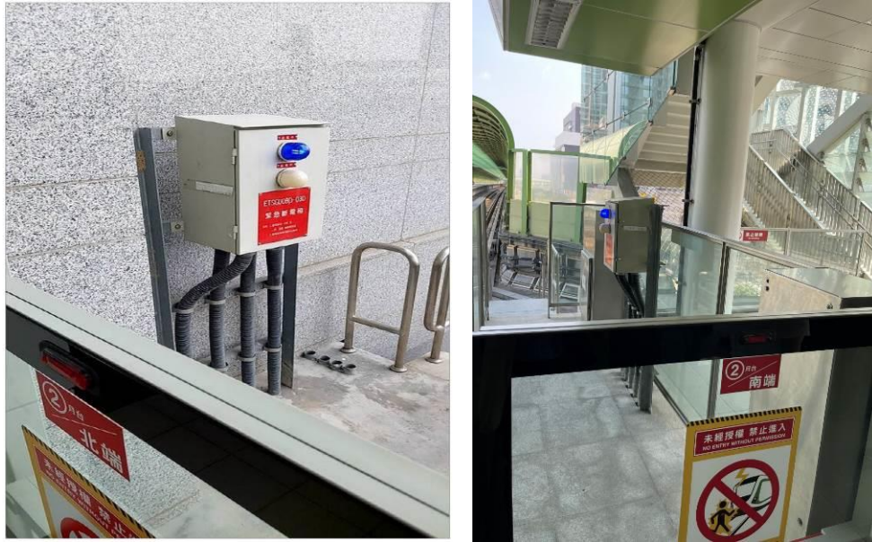
照片5 月台端牆門外方緊急斷電設備
