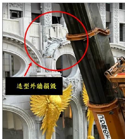
圖10 位於低層樓之造型外牆受損
