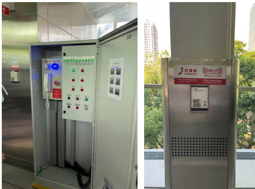
照片6 月台門控制盤上鎖箱體內緊急斷電設備(左)、月台對講機(右)
