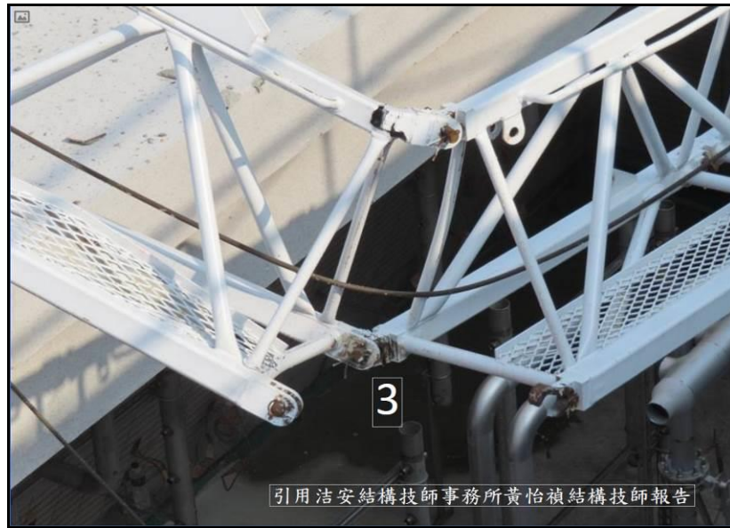
照片2 破壞點(3)伸臂掉落時撞擊屋頂時折斷
