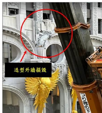
圖10 位於低層樓之造型外牆受損
