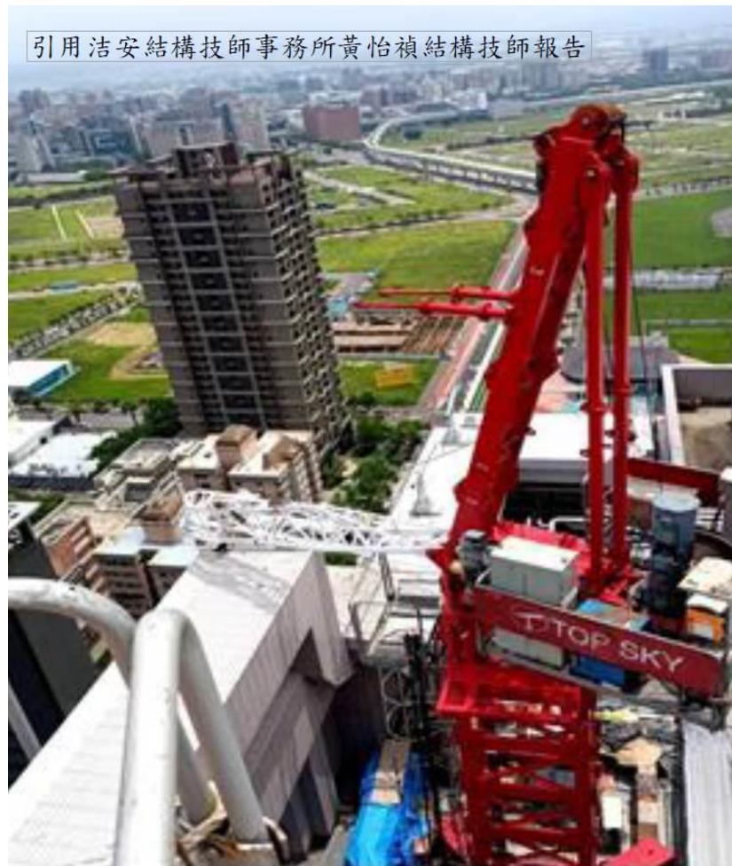
照片4 現場實際方位如所示，拆除機伸臂與外牆面至少夾50°角
