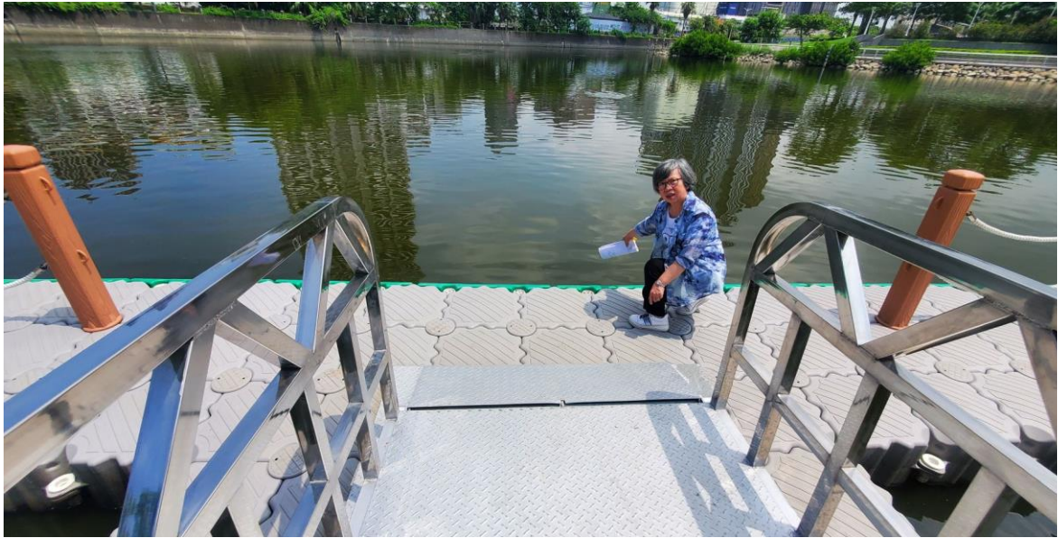
圖10、本院實地履勘發現部分碼頭空間難以容納輪椅轉向
