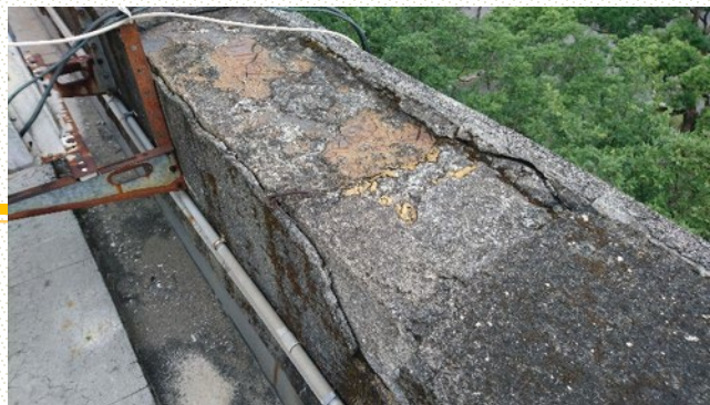
頂樓女兒牆剝落受損狀況嚴重
