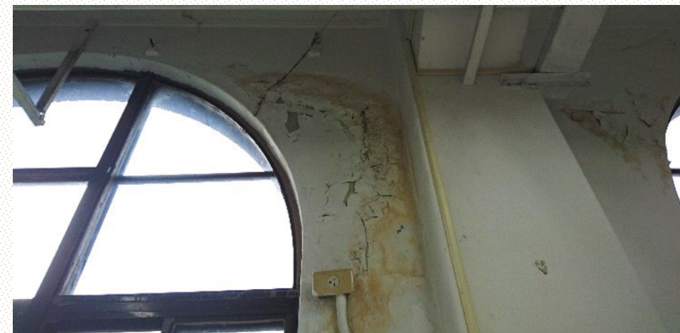
室內漏水痕跡
