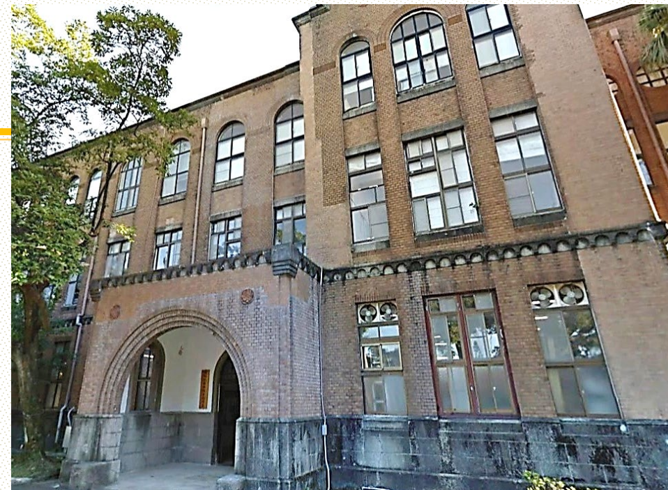
外牆斑駁且防水功能不佳
