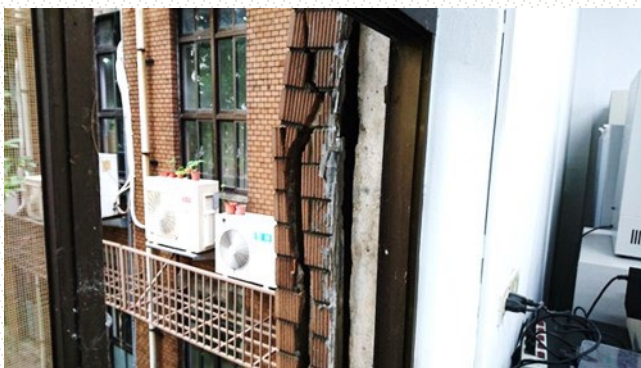
磁磚凸起開裂狀況嚴重
