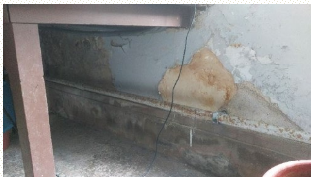
室內壁癌嚴重
