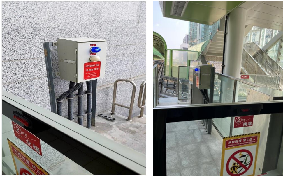
照片5 月台端牆門外方緊急斷電設備
