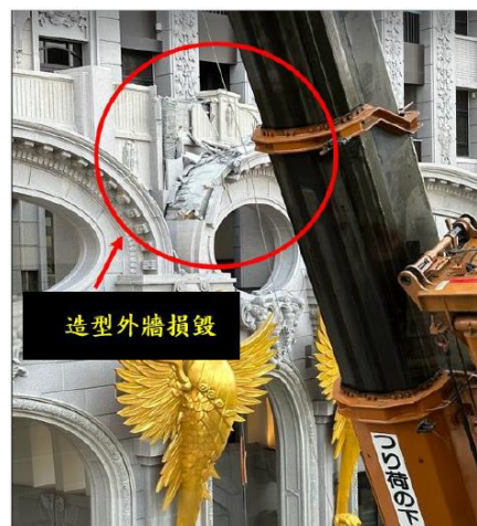
圖10 位於低層樓之造型外牆受損
