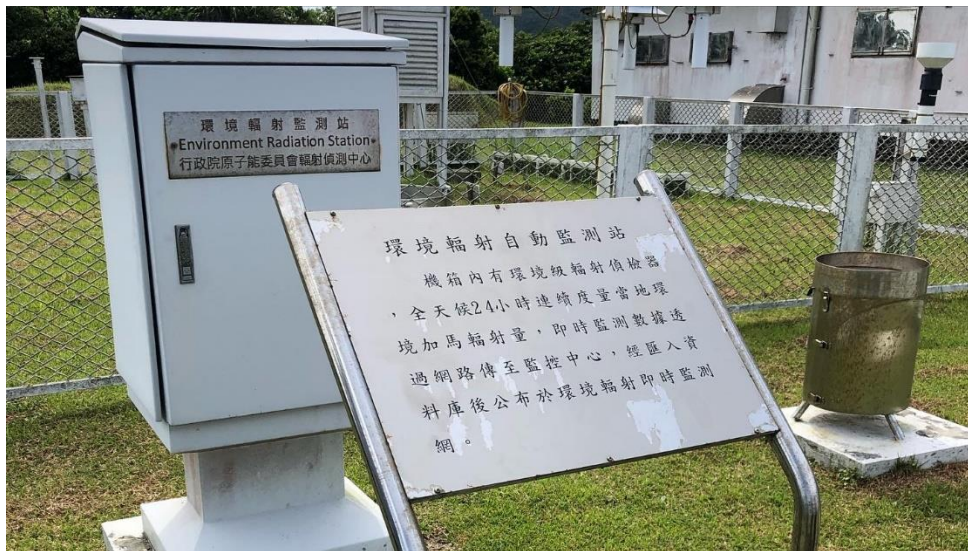
圖9 環境輻射監測站
