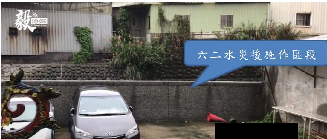
(c) 六二水災後完成施作之區段（資料來源：網路截圖， https://www.youtube.com/watch?v=63N0rbZHiBU ）
