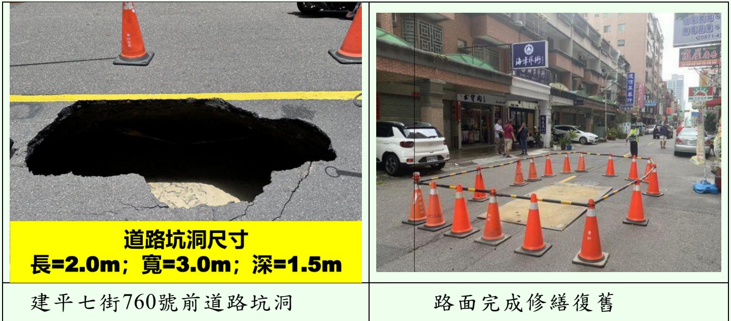
圖4 建平七街760號前道路坑洞及修繕情形
