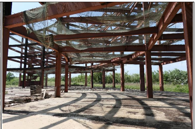
圖2 工區閒置情形，本院112年9月27日攝。
