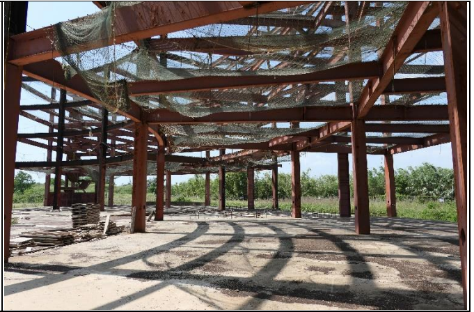
圖2 工區閒置情形，本院112年9月27日攝。
