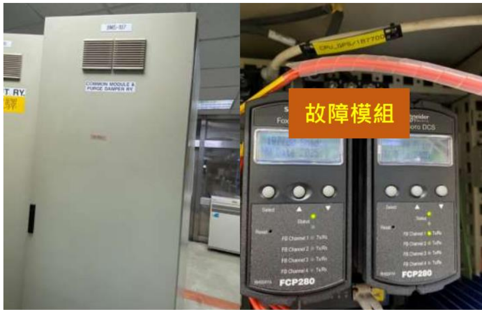
圖7 現場控制箱盤照片
