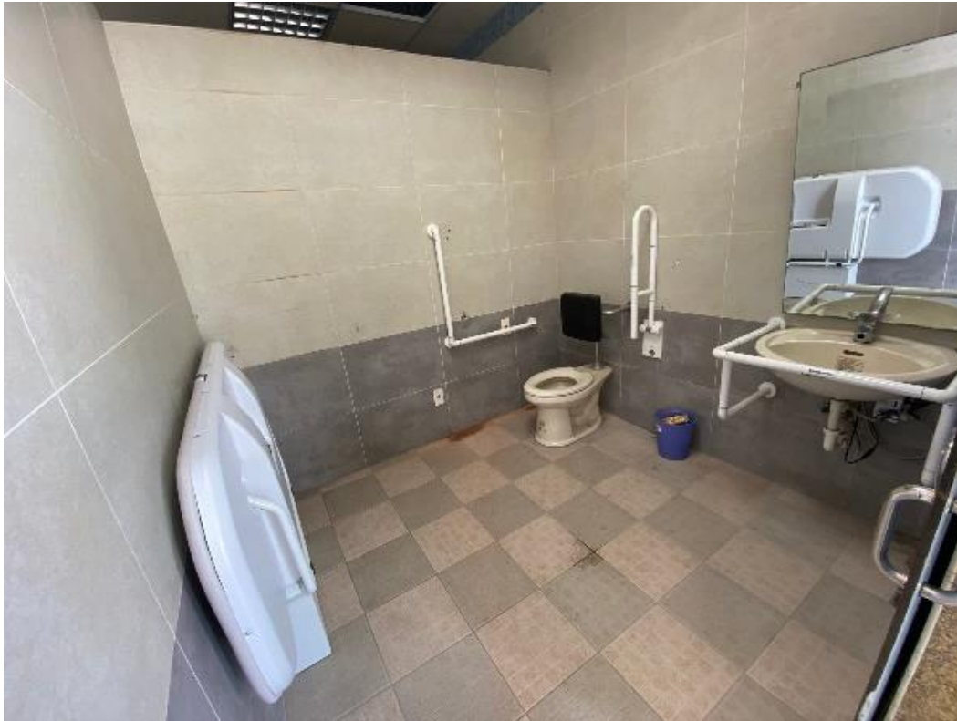
圖23 鶯歌國中特教專用廁所及無障礙廁所（含盥洗盆、照護床、求助鈴）、廁所身障扶手（2/8）
