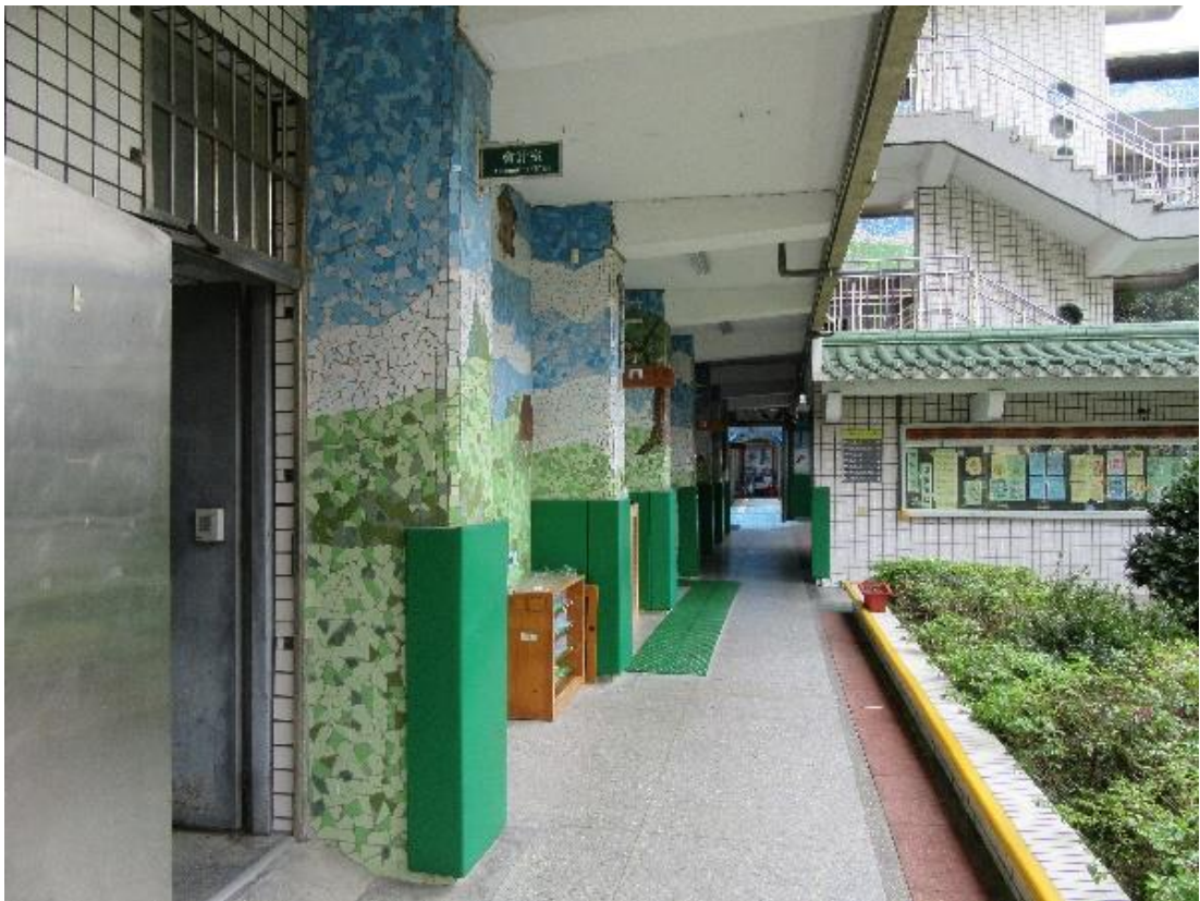
圖20 鶯歌國中1F特教、教室、幼兒園區域樑柱、牆角處設置防撞條 (2/3)
