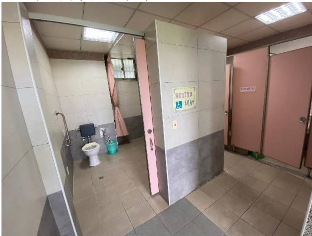
圖26 鶯歌國中特教專用廁所及無障礙廁所（含盥洗盆、照護床、求助鈴）、廁所身障扶手（5/8）
