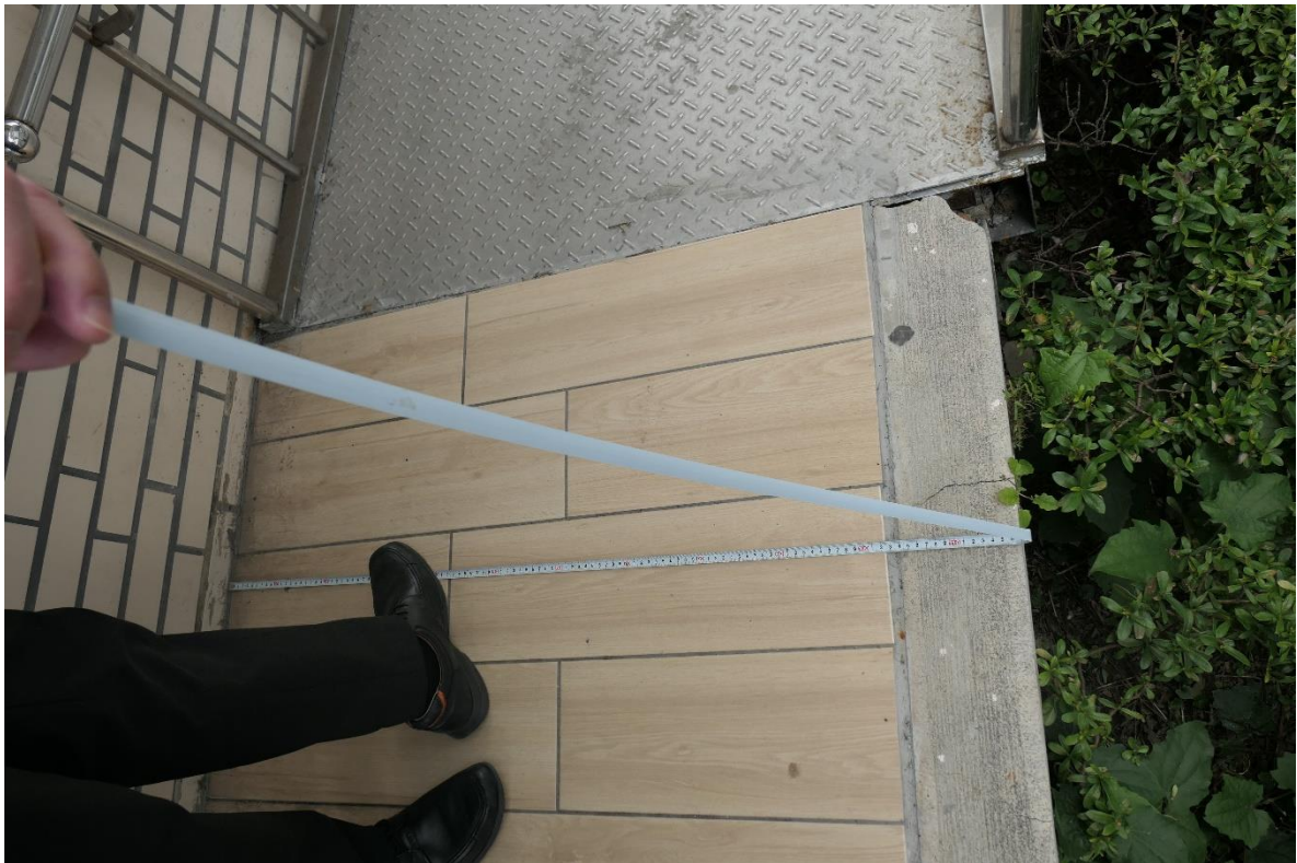
圖8 木柵高工司令臺無障礙設施建置情形（寬度約117公分）
