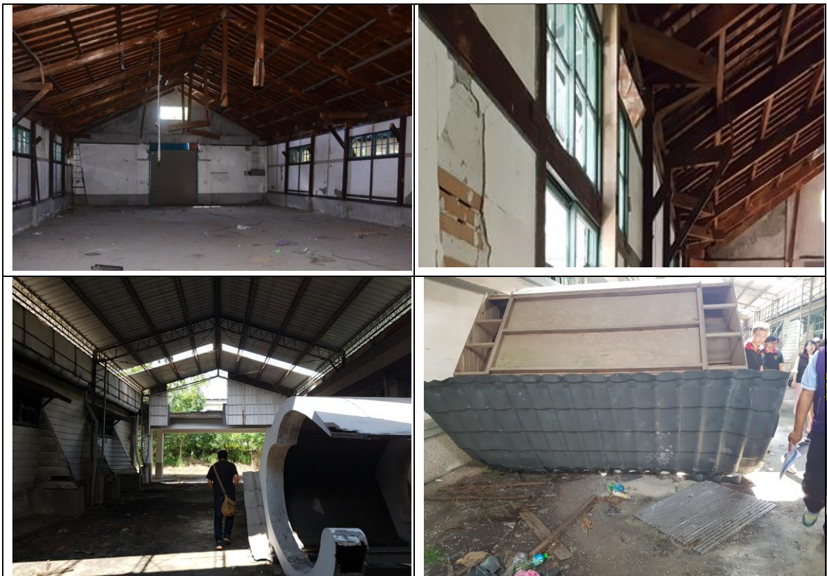
圖 6 花蓮菸葉廠建物檜木樑柱遭竊，造成建物塌陷、結構岌岌可危
