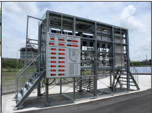
99.06.18 台南縣廣運機械工程股份有限公司太陽能發電系統控制面板
