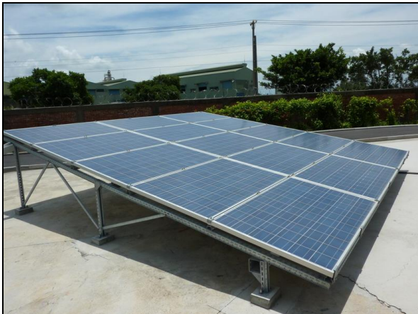
99.06.18 台南縣廣運機械工程股份有限公司太陽能面板。
