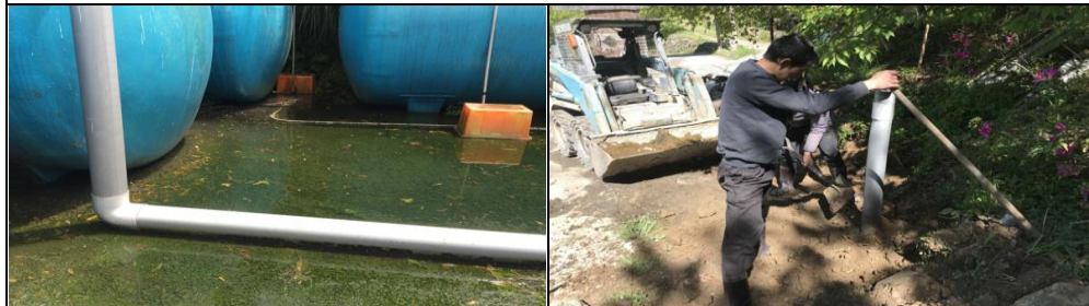
A區處理槽：進水井、藍色的污水為期改善惡臭問題，族人增設排處理槽，不斷的溢出來污水，污氣孔，希望連到各家戶、民宿的臭味可以減緩，惟執行成效有限。水就積在水泥地上。
