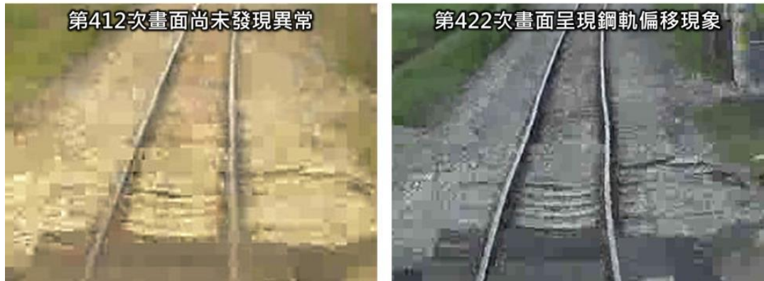
圖6 第412、第422次列車鋼軌偏移增加情形
