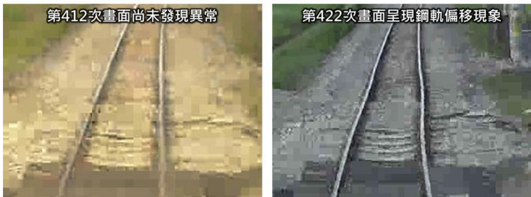
圖6 第412、第422次列車鋼軌偏移增加情形
