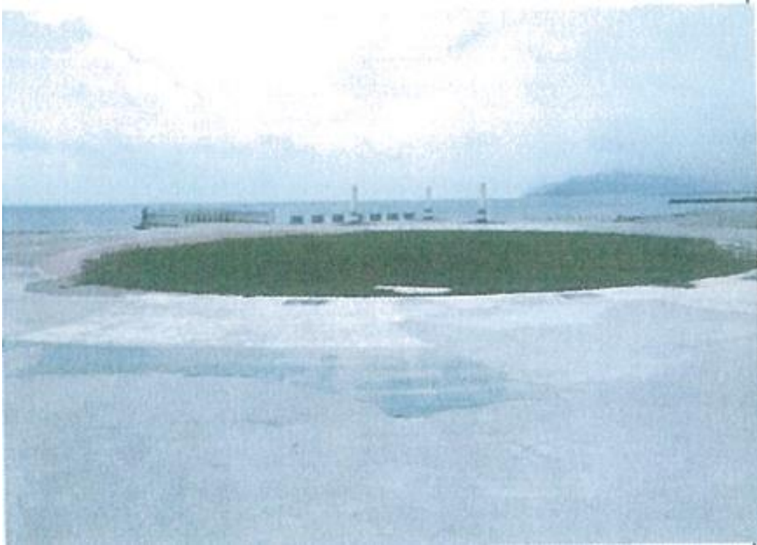
照片 5、北濱海岸舊漁村休閒設施完工後尚無法補辦建築執照之閒置現況
