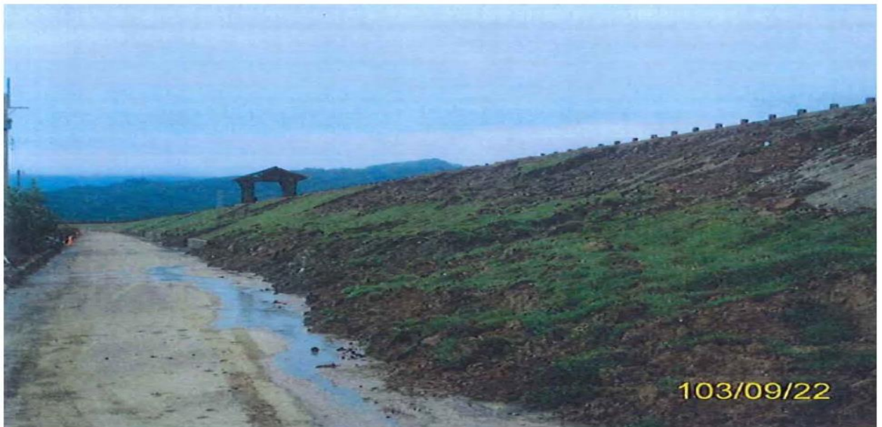
照片2 103年9月22日堤後坡植被土壤滑落情形
