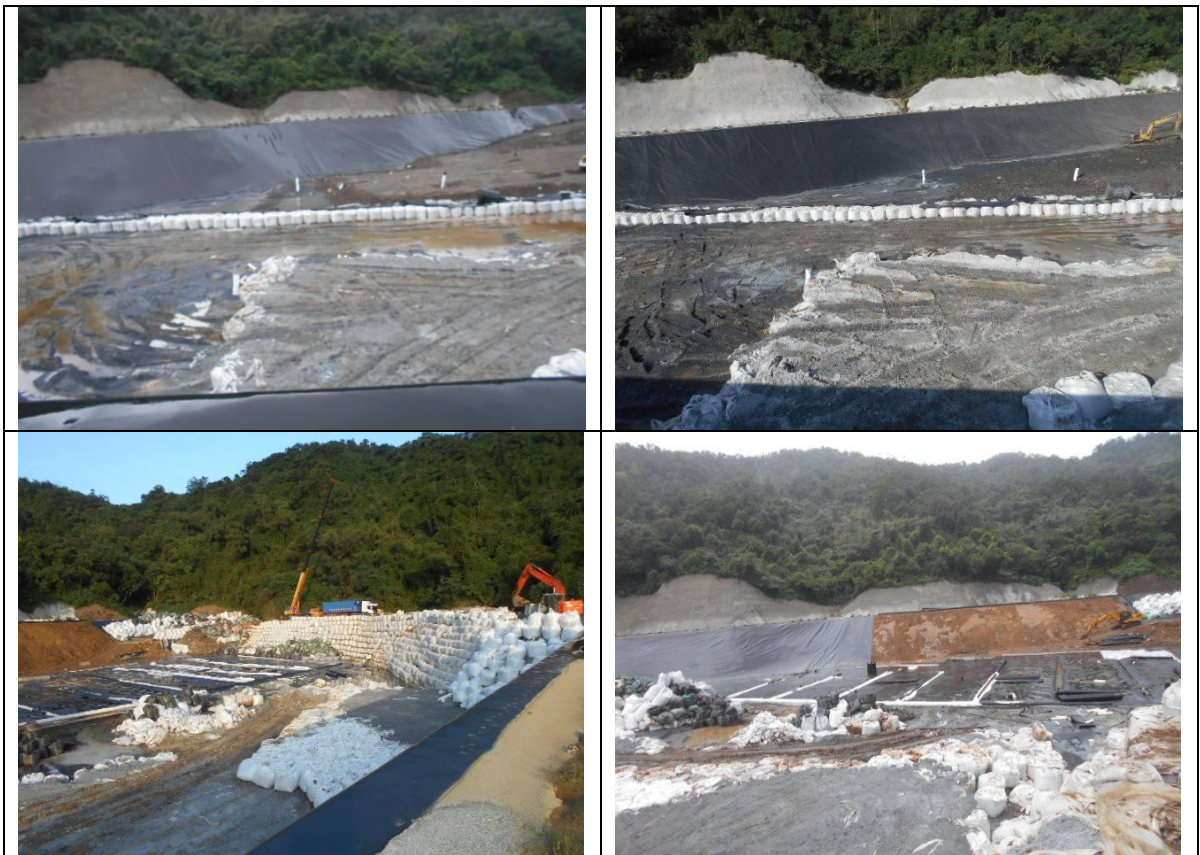
圖7 系爭處置場設置獨立分區掩埋及滲出水收集系統之情形
