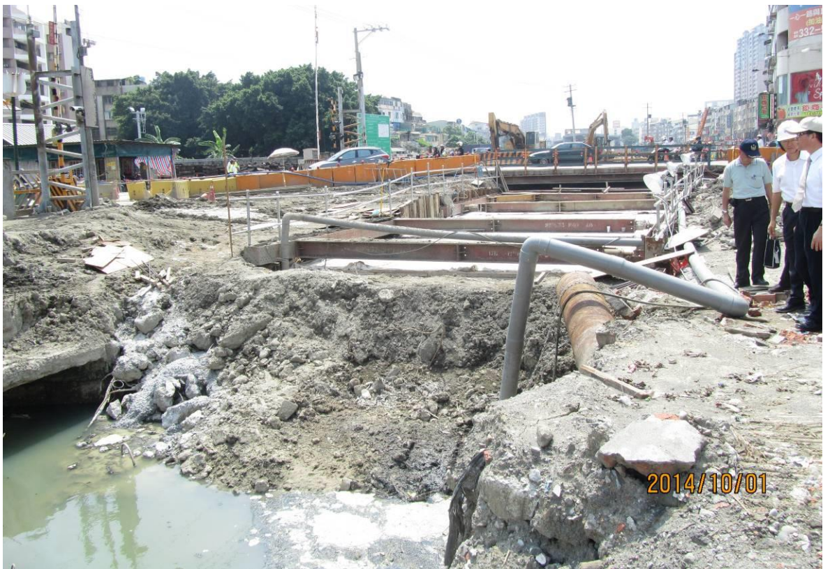
照片 2、本案氣爆災害現場－凱旋路及二聖路口之本案氣爆管線、地下排水箱涵及復原重建情形(本調查案於 103 年 10 月 1 日拍攝)
