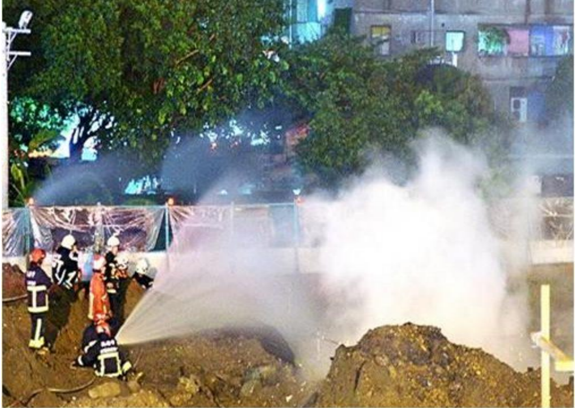
照片 3、本案氣爆災害發生前黃金 3 小時現場冒白煙情形 (資料來源：高雄市政府 103 年 10 月 1 日履勘簡報，本調查案轉載)
