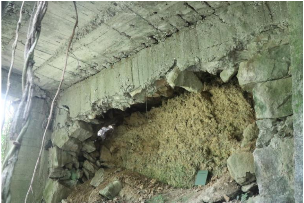
圖7 保元宮前埕之樑柱下方整坡堆置的土壤，因自然壓密而在上方出現孔洞，推測此為鋪面龜裂陷落之主因
