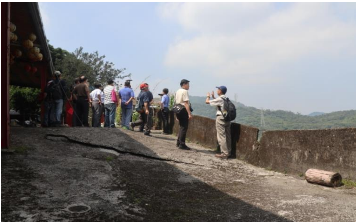
圖6 18號鐵塔旁之保元宮，前埕水泥鋪面向西側滑動陷落及地表破裂
