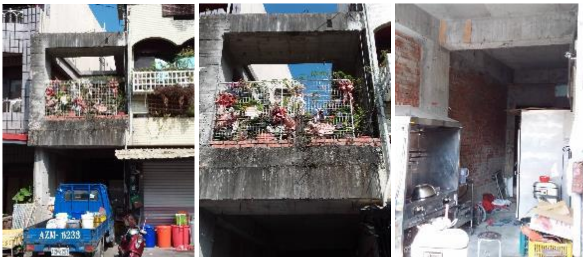
(縣府提供) 108年12月2日系爭違建現況
