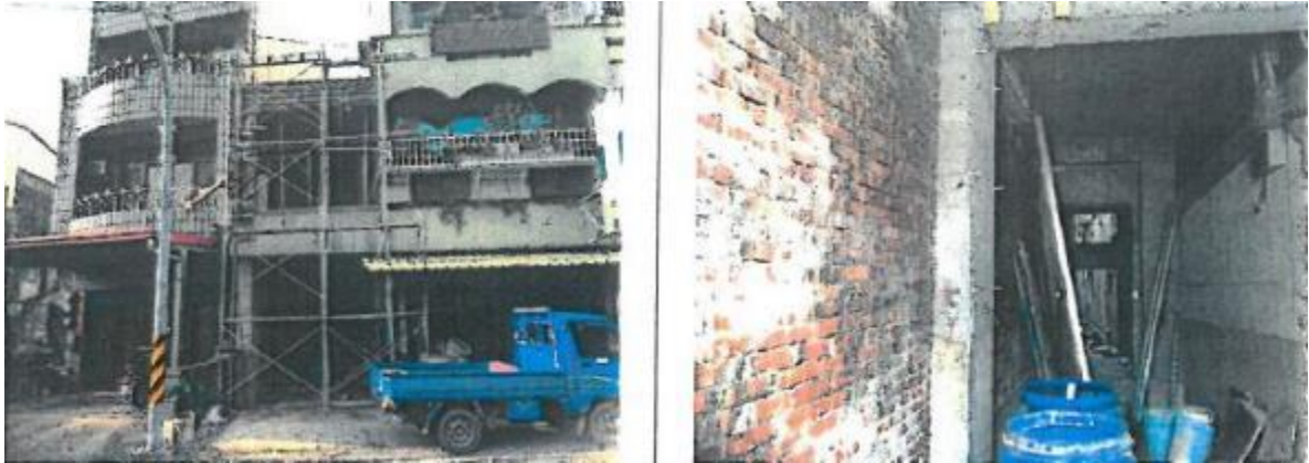
古坑鄉公所105年6月30日違建查報通知單，違章查報現況照片 違建面積： (1.4+2.9)*10/2=21.5\text{m}^2 ，施工完成程度40%。
