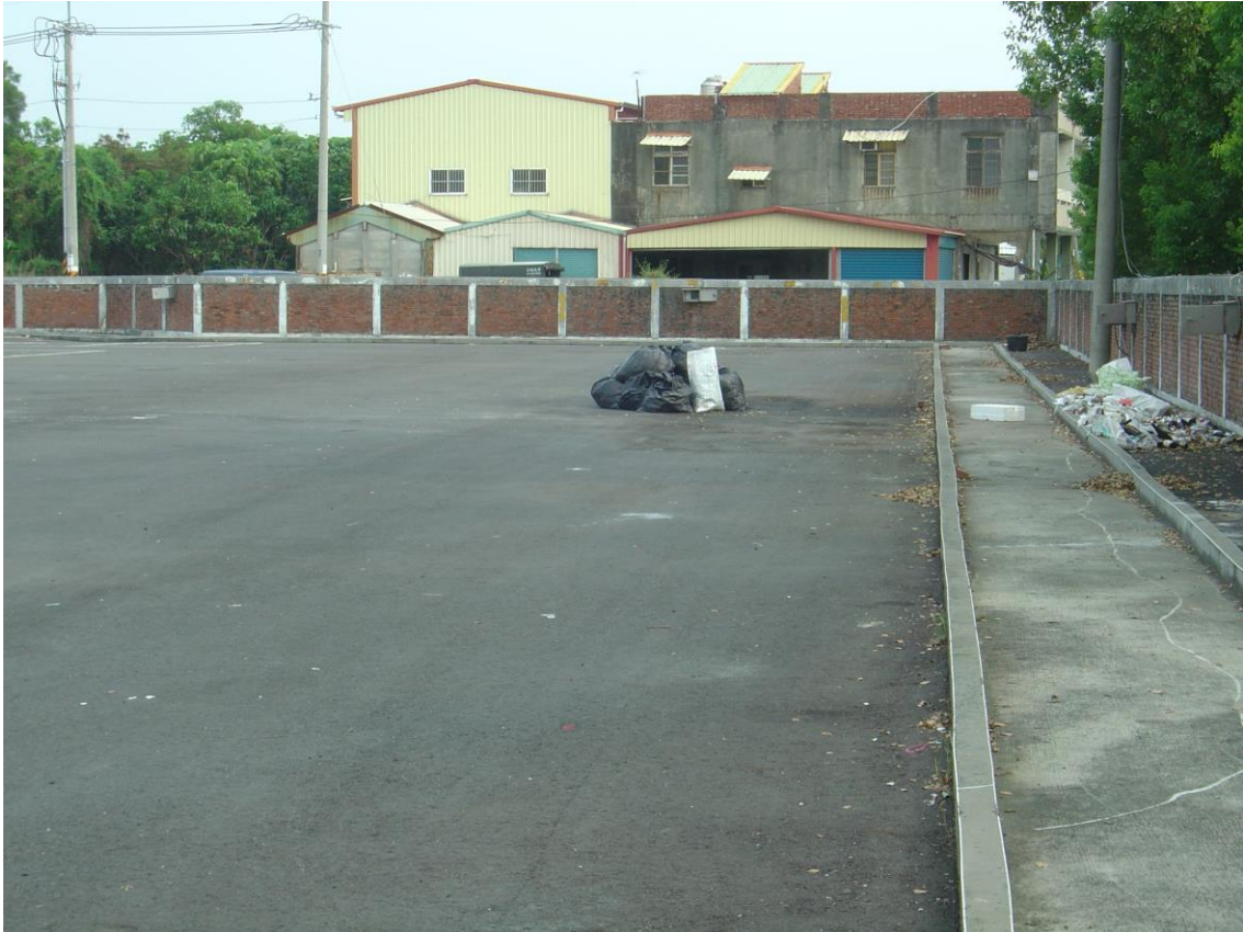
附圖十、社頭鄉產業發展推廣中心之行動不便者引道一路拱排水設施不良(四)
