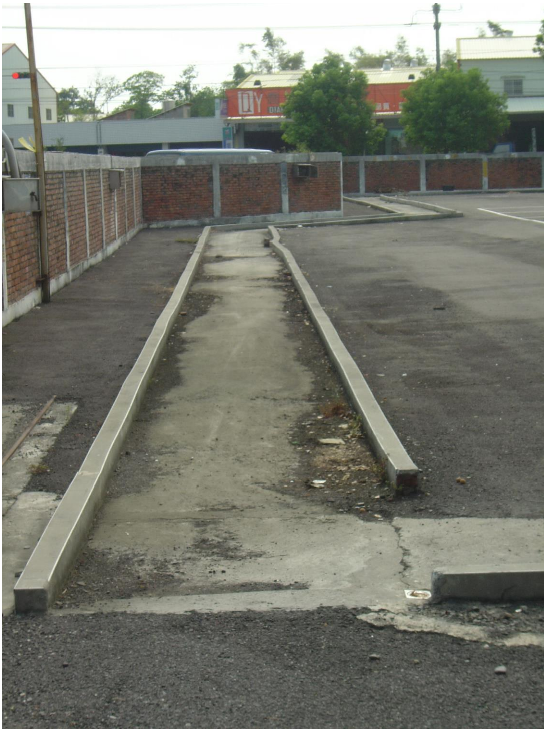
附圖九、社頭鄉產業發展推廣中心之行動不便者引道一路拱排水設施不良(三) (引道至產業中心長達 139.5 公尺且環繞 5 處彎道) (依經濟部中小企業處召開之變更設計審查會議之審查結果：「露天路面及無障礙坡道避免選用濕滑之建材並注意天雨路滑之安全考量。」) (98 年 9 月 10 日拍攝，迄 99 年 11 月 18 日仍未改善)
