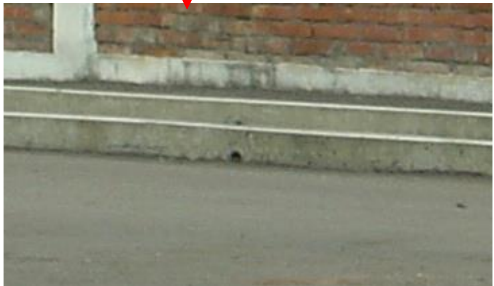
附圖八、社頭鄉產業發展推廣中心之行動不便者引道-路拱排水設施不良(二) (兩側路面高於引道) (依經濟部中小企業處召開之變更設計審查會議之審查結果：「露天路面及無障礙坡道避免選用濕滑之建材並注意天雨路滑之安全考量。」) (98年9月10日拍攝，迄99年11月18日仍未改善)
