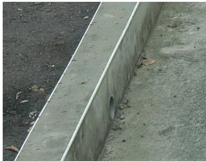
附圖七、社頭鄉產業發展推廣中心之行動不便者引道-路拱排水設施不良(一) (兩側路面高於引道) (依經濟部中小企業處召開之變更設計審查會議之審查結果：「露天路面及無障礙坡道避免選用濕滑之建材並注意天雨路滑之安全考量。」) (98年9月10日拍攝，迄99年11月18日仍未改善)
