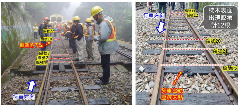
圖9 第11-22根枕木表面有明顯列車出軌壓痕
