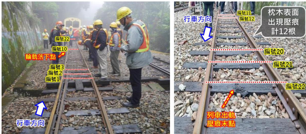
圖9 第11-22根枕木表面有明顯列車出軌壓痕
