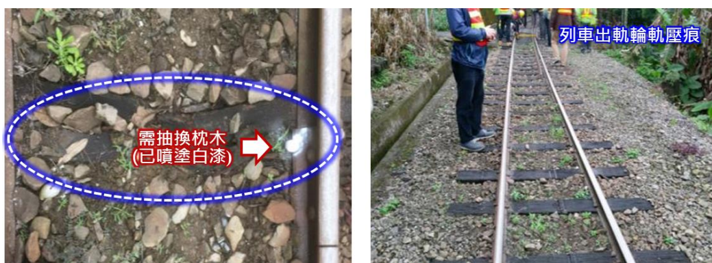
圖13 事故路段位處潮濕環境，道碴厚度似有不足情事
