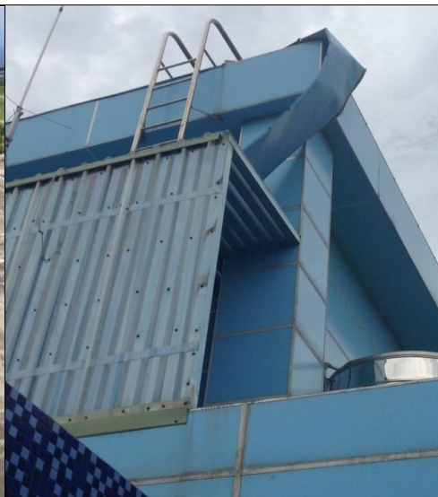
頂樓鋁板多處剝落
