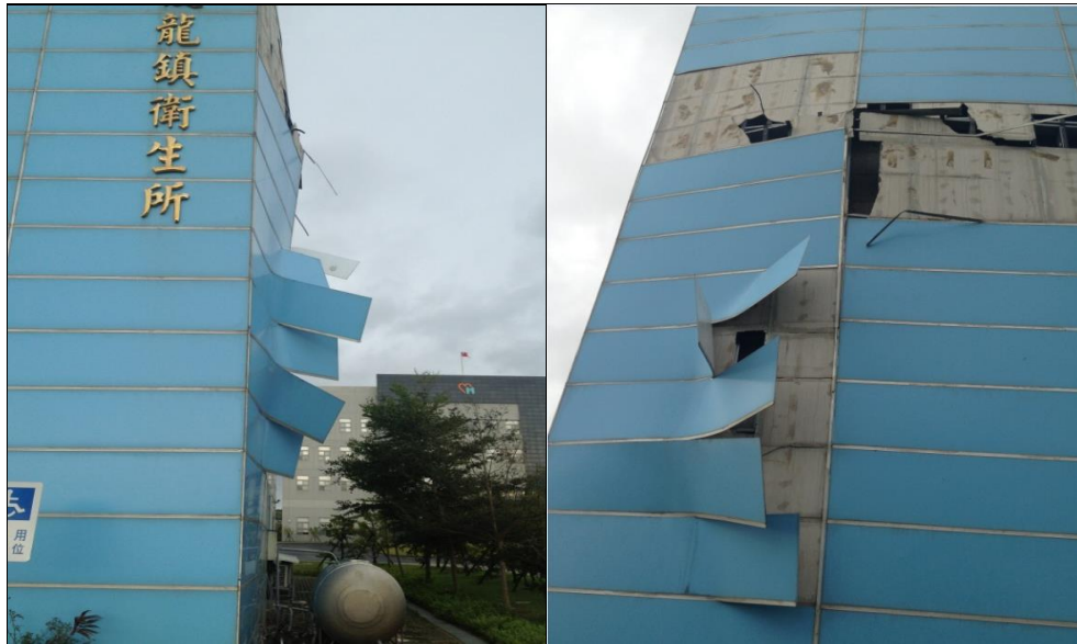
外牆壁鋁板、鋼條多處嚴重剝落變形與主結構分離
